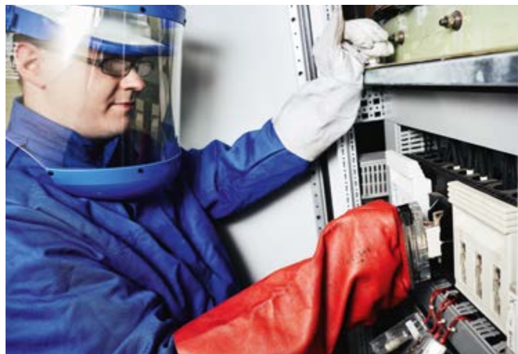
Servicetechniker in einer Windenergieanlage
