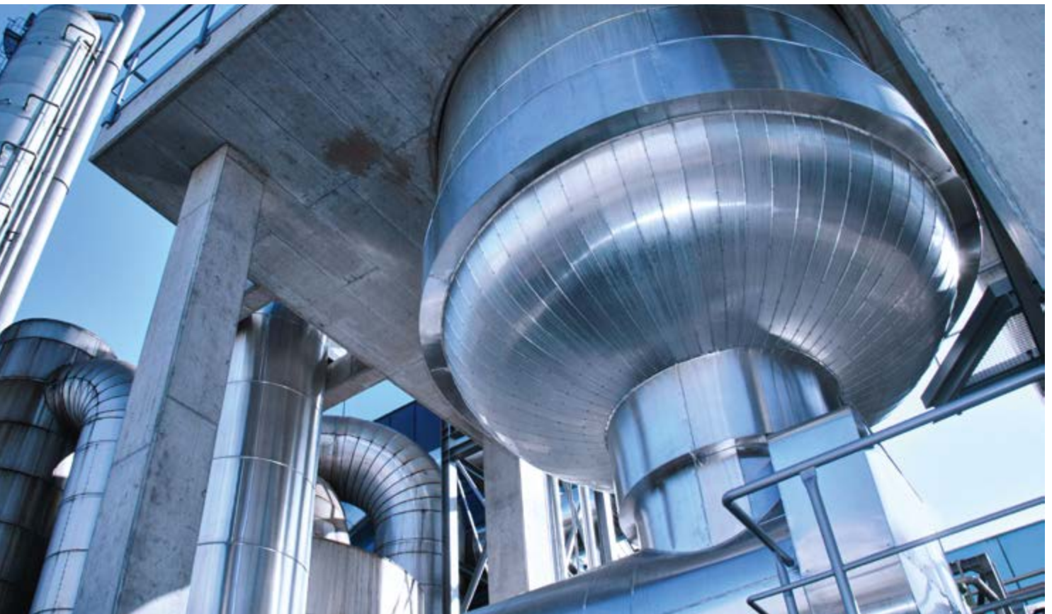
Filter-Anlage mit EnviNOx-Technologie zur Reduzierung von N_2O - und NO_x -Emissionen
